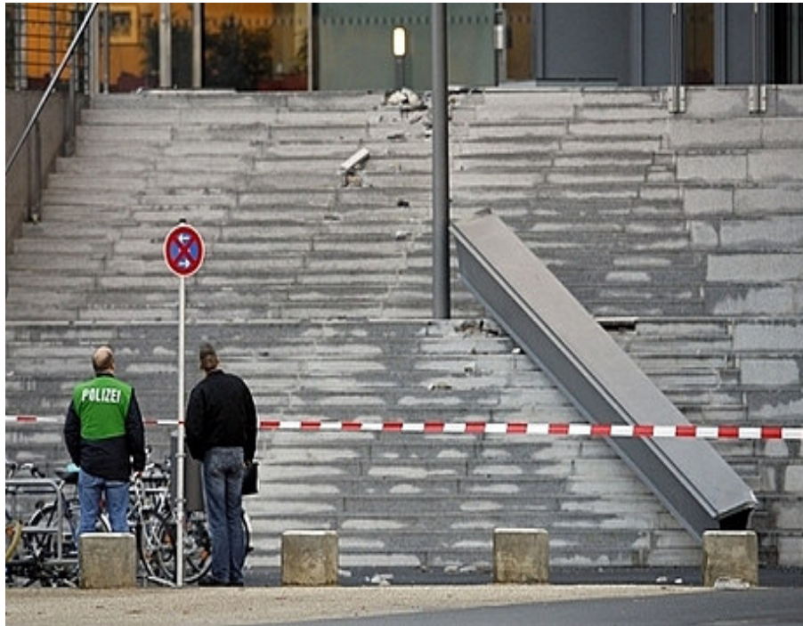
Lehrter Bahnhof, Berlin nach Sturmschaden
